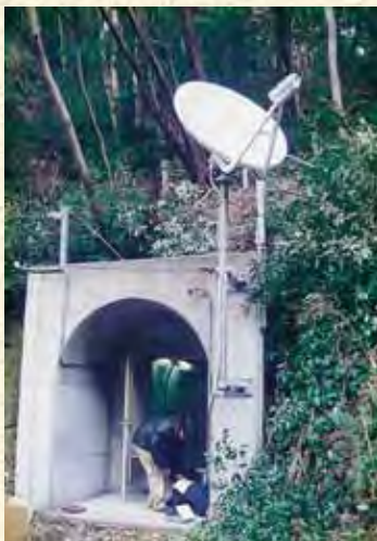
地震観測点： 長さ30mのトンネルの奥に 高感度地震計，広帯域地震計 など様々な装置が設置されて いる。(野母崎観測点)
